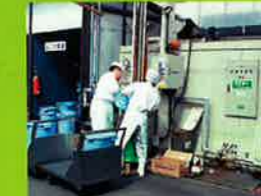
設置例(北村山公立病院)
