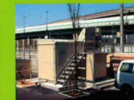
設置例(東大阪学校給食センター)
