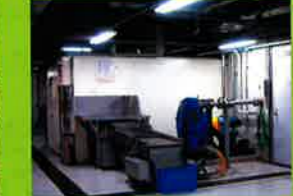
設置例(東京ドームホテル)
