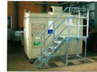
投入用階段ステージ/換気装置
