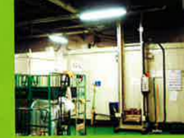
設置例(デパート2台)
